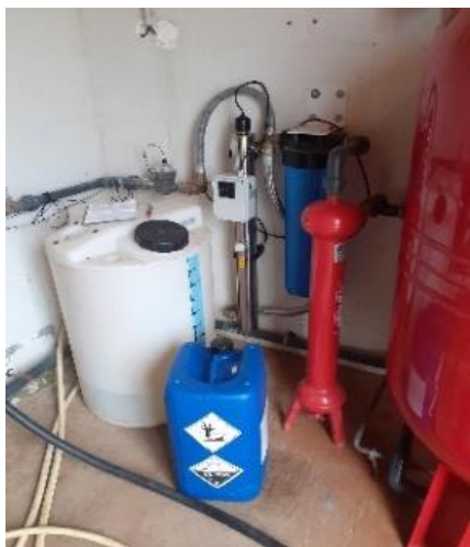
Figure 1 - Dispositifs de traitement de l'eau
